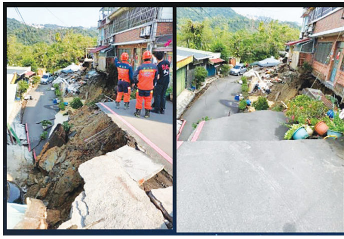
▲新店區安泰路地基掏空，土陷嚴重。
